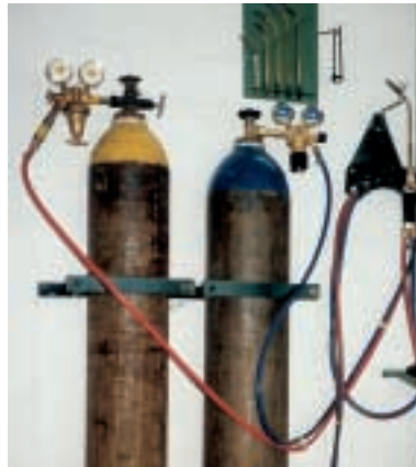
Gasschweißanlage mit Brennerhalterung und sicherer Flaschenaufstellung
